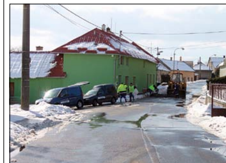
Havárie vodovodu ve Veselíčko kvůli silným únorovým mrazům. Vodovody a kanalizace opravovali havárii například v úseku od hospody U kovářny po zastávku U kovářny a lidem netekla voda.
