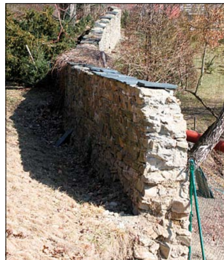
Řešení havarijního stavu jižní zámecké zdi
